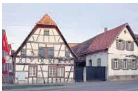
Vorher: Das Fachwerkhaus sitzt zu tief, die unteren Bereiche sind abgängig, doch ...
