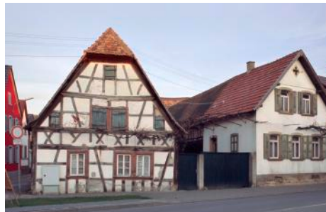
Vorher: Das Fachwerkhaus sitzt zu tief, die unteren Bereiche sind abgängig, doch ...
