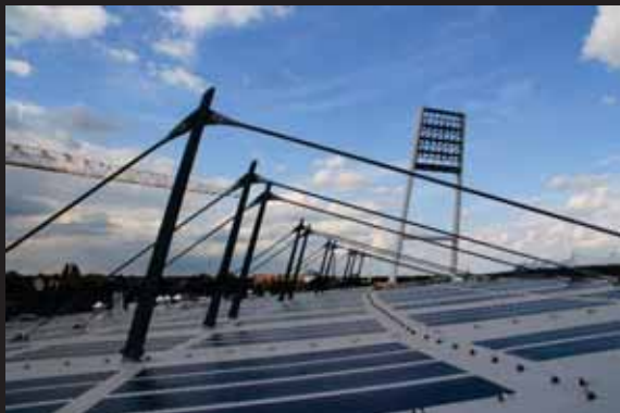
Dachlandschaft mit PV Dachbahn
